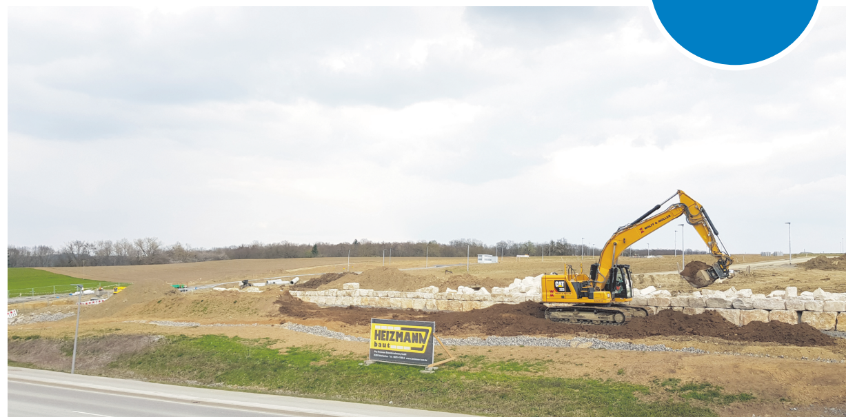
Im neuen Wohnbaugebiet in Gaisbach an der Waldenburger Straße wird kräftig gearbeitet. Aufgrund der großen Bauplatz-Nachfrage wird bereits eine klimaneutrale Erweiterung geplant. Foto: Stadtverwaltung Künzelsau.
